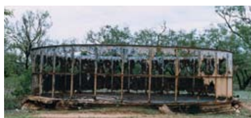
Результат недостаточной защиты от коррозии
